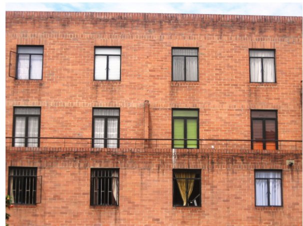
Figura 3. Ensuciamiento. Fuente: Autor.
