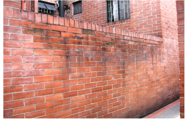
Figura 5. Humedad, eflorescencias, ensuciamiento, erosión. Fuente: Autor.
