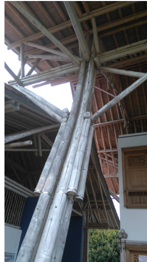
Figura 8. Columna en guadua afectada. Fotodegradación, fisuras, ensuciamiento. Fuente: Autor.
