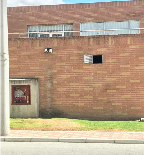
Figura 7. Humedad, ensuciamiento, eflorescencias. Fuente: Autor.
