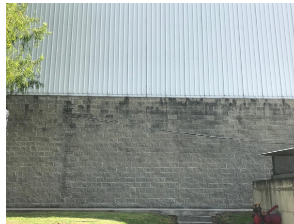
Figura 6. Ensuciamiento. Fuente: Autor.
