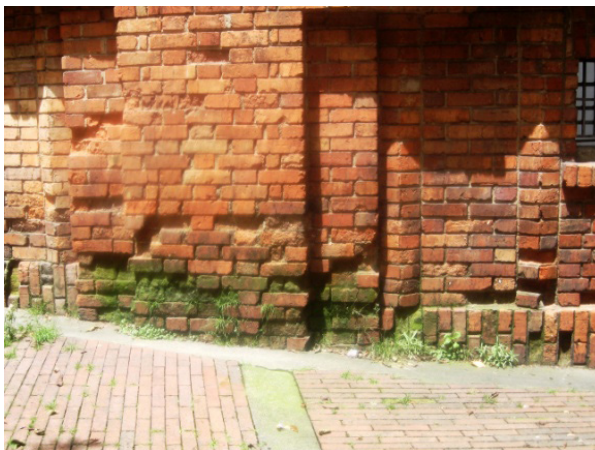
Figura 1. Humedad, erosión y musgo. Fuente: Autor.
