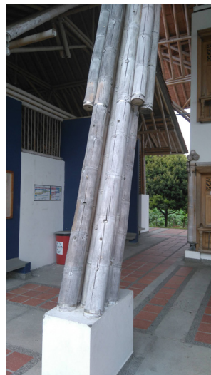
Figura 9. Columna en guadua afectada. Fotodegradación, fisuras, ensuciamiento. Fuente: Autor.
