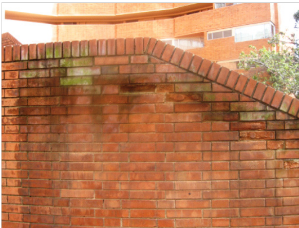
Figura 4. Humedad, eflorescencias, ensuciamiento, erosión. Fuente: Autor.
