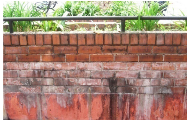
Figura 2. Humedad Ensuciamiento, eflorescencias. Fuente: Autor.
