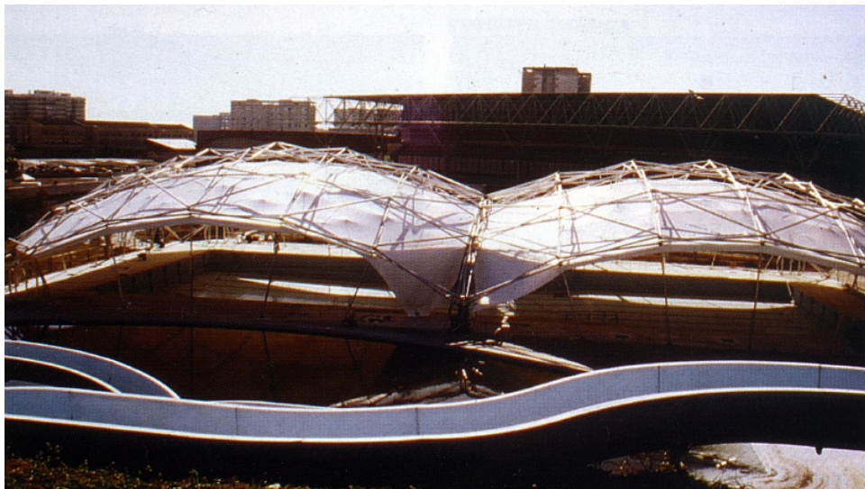
Figuras 15, 16 y 17. Una vez situada en la posición del desplegado. Posteriormente, es fácil de desplegar la estructura con su membrana y colocarla en su sitio, por medio de una grúa conectada en ocho puntos, para anclarse a los soportes. Fuente: Escrig & Sánchez, 1999.
