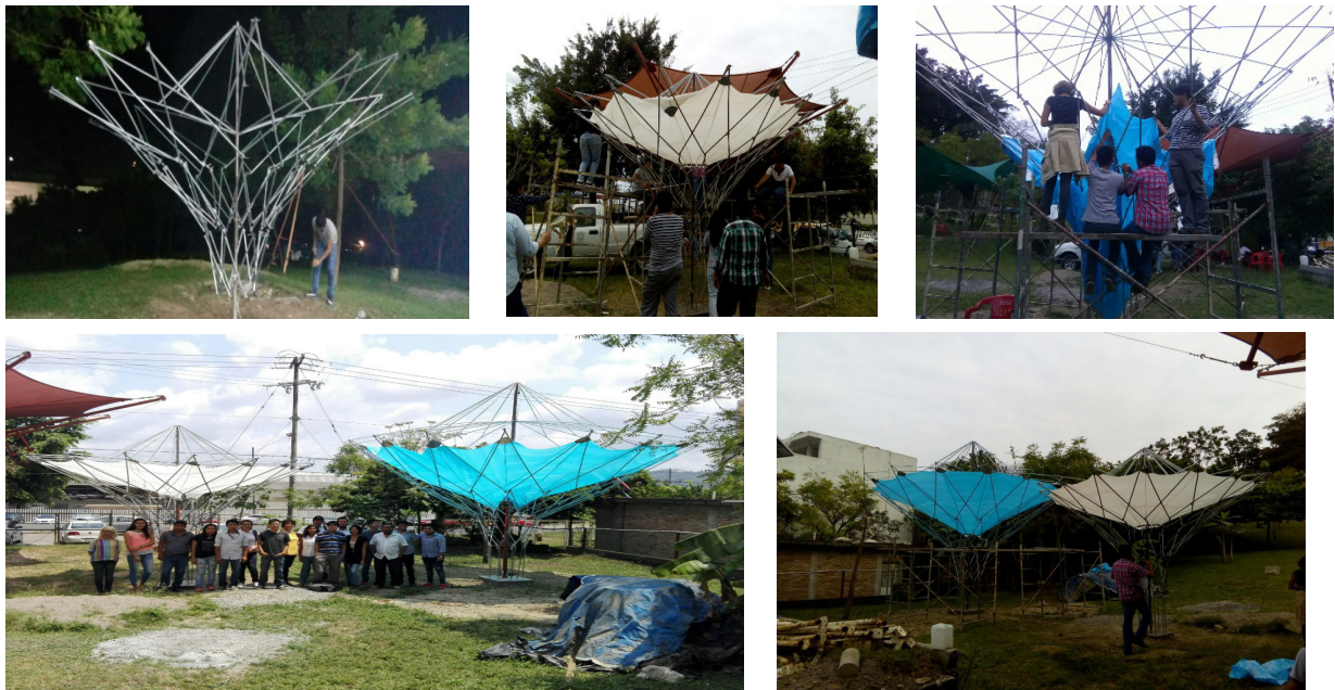
Figuras 49 al 53. El proceso de alzado ayuda a determinar cómo se comportaría el modelo en la construcción y como serían sus deformaciones en algunas partes de la cubierta.
